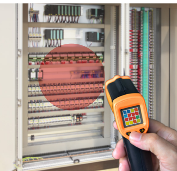
变压器、配电柜
